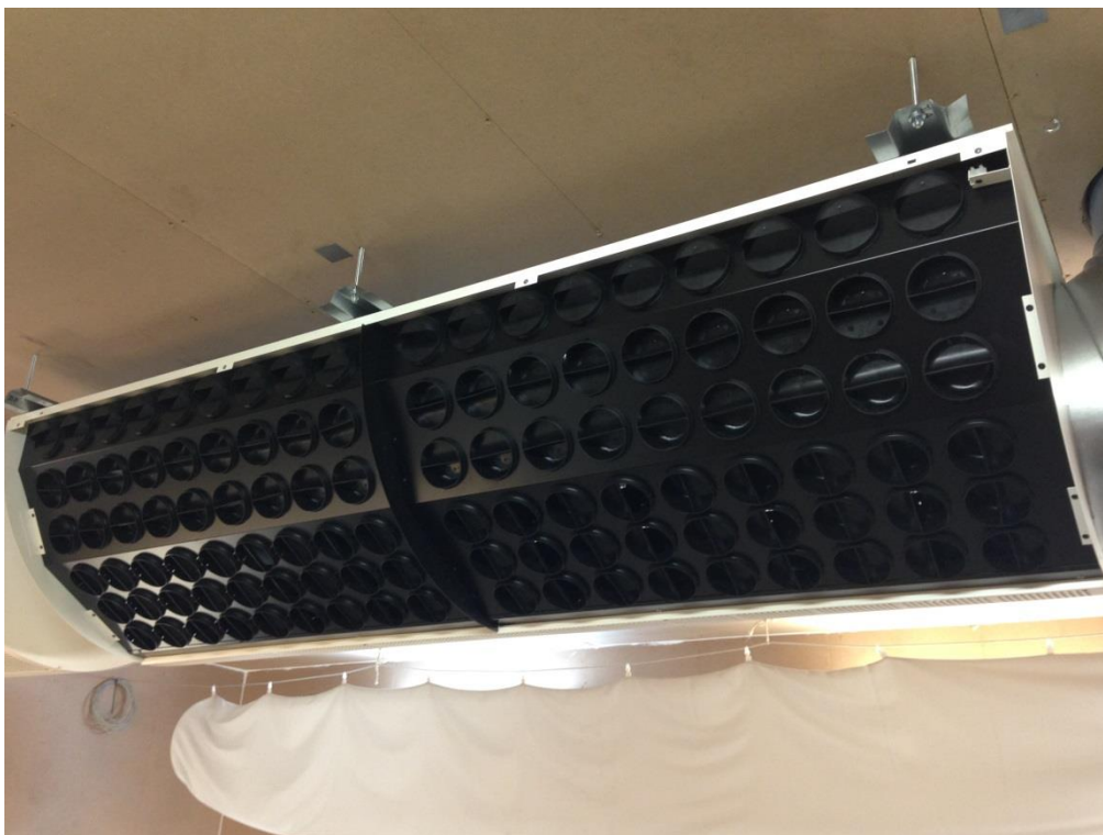
Figur 20 – Her ses fortrængningsarmatur med fabriksindstillede dyser.
