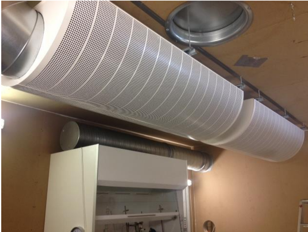
Figur 19 – Der installeres i alt 2 fortrængningsarmaturer.
